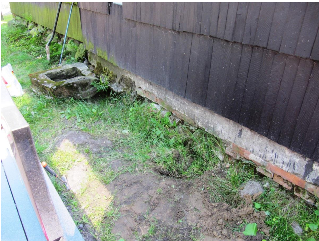
Fot. 3. Zły stan podmurówek przy zakrystii i przedsionku
