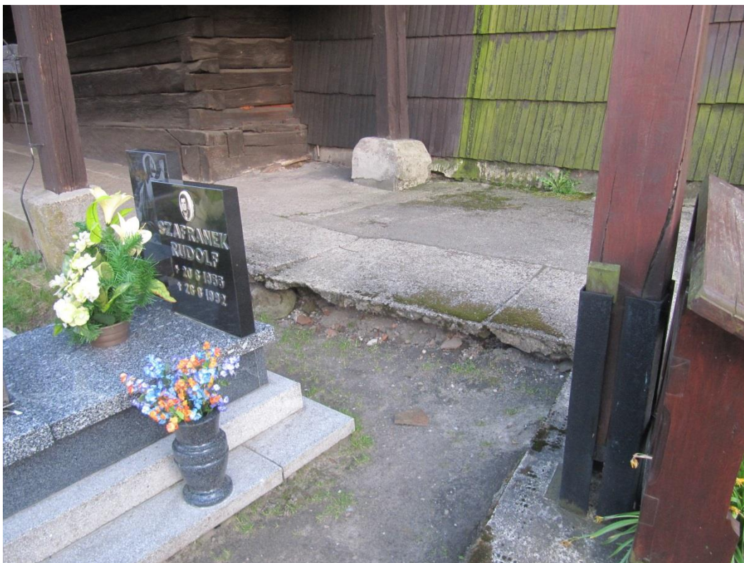
Fot. 21. Uszkodzenia betonowej nawierzchni pod sabotami od północy
