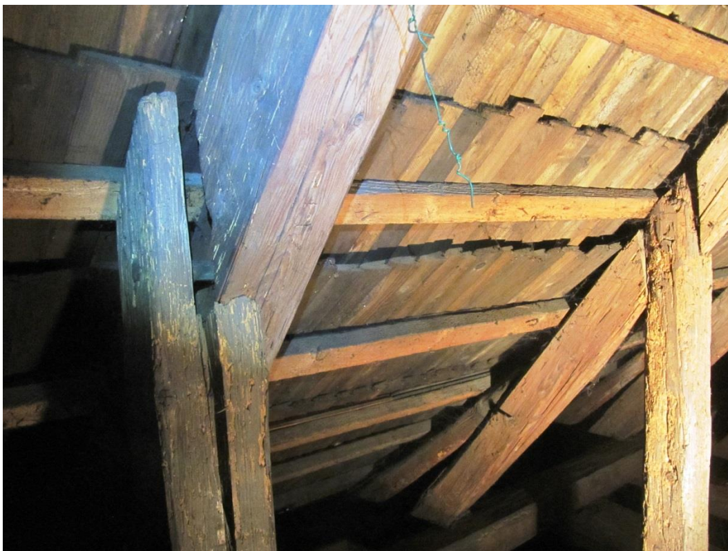
Fot. 13. Uszkodzenia połączeń więźby wynikające z przechylenia konstrukcji
