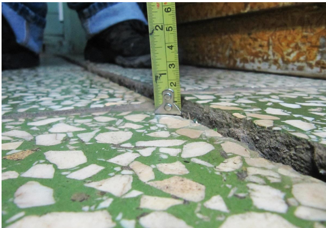
Fot. 5. Pęknięcie posadzki w zakrystii, z pionowym przemieszczeniem, spowodowane osiadaniem fundamentu pod ścianą zewnętrzną
