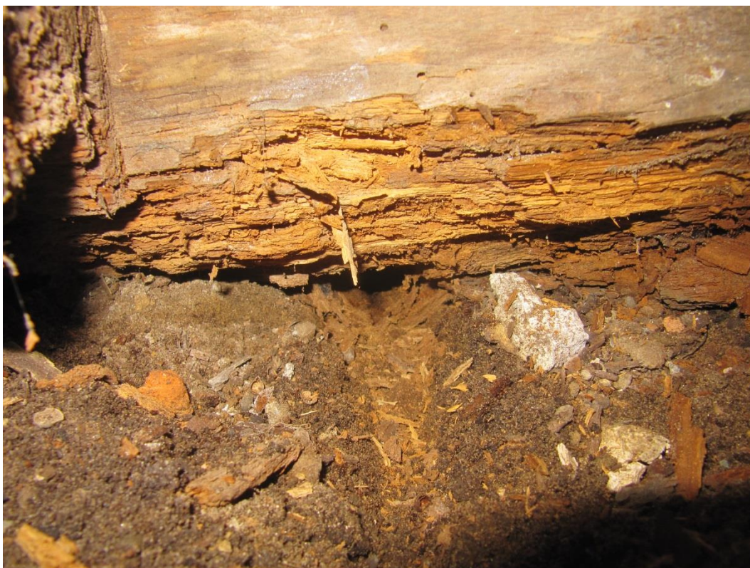
Fot. 8. Zbutwiałe podwaliny ścian wieńcowych zakrystii
