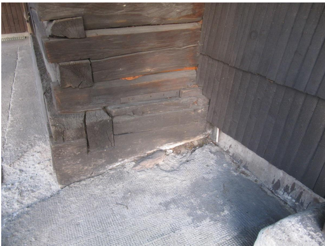
Fot. 20. Obetonowane podwaliny – uszkodzenia korozyjne
