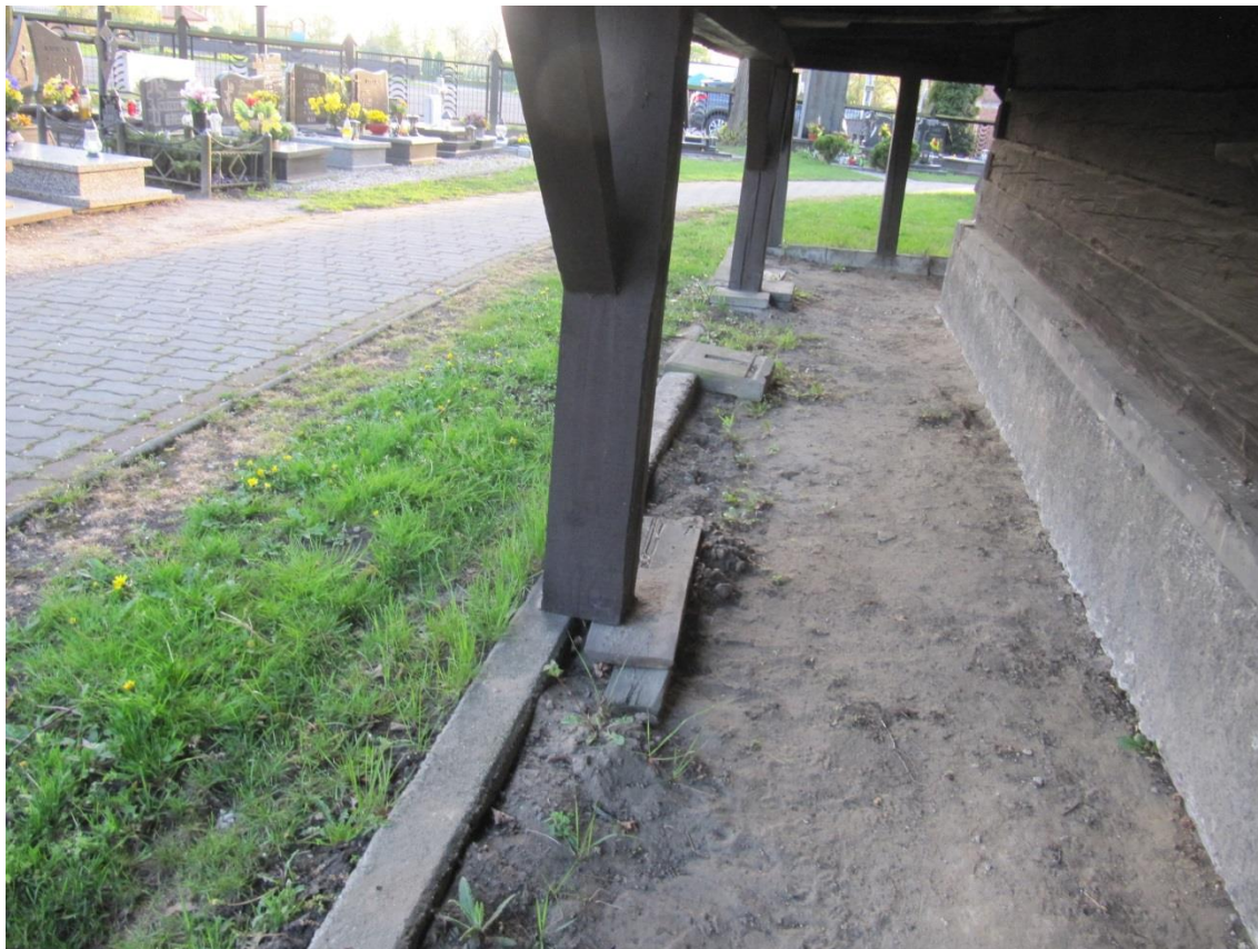
Fot. 24. Nawierzchnia gruntowa pod sabotami od strony południowej
