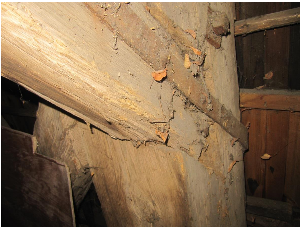
Fot. 15. Uszkodzenia korozyjne połączeń słupów z zastrzałami w wieży
