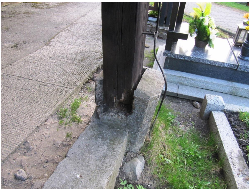
Fot. 19. Rozłupany słupek cokołu pod sabotami
