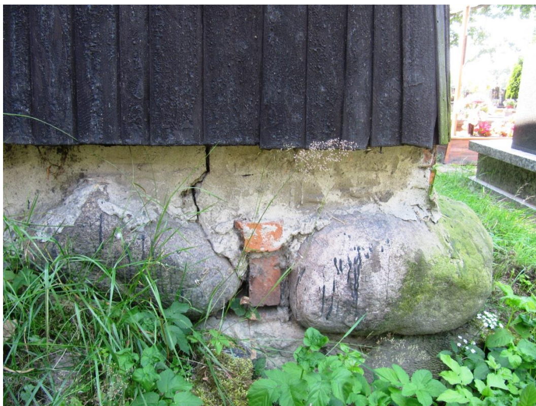
Fot. 4. Pęknięcie podmurówki zakrystii spowodowane osiadaniem fundamentu
