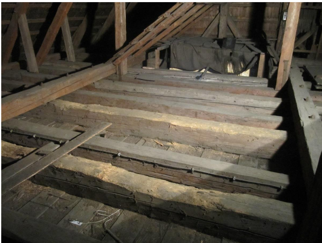
Fot. 11. Stan konstrukcji stropu nad nawą – zniszczenia biologiczne drewna
