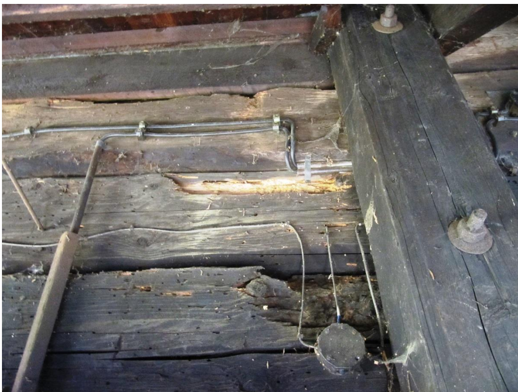
Fot. 10. Korozja biologiczna bali zrębu – ściana południowa przy lisicy
