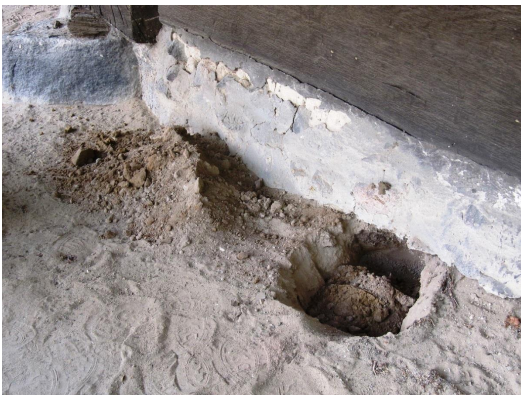
Fot. 6. Brak fundamentu pod podmurówką ścian prezbiterium
