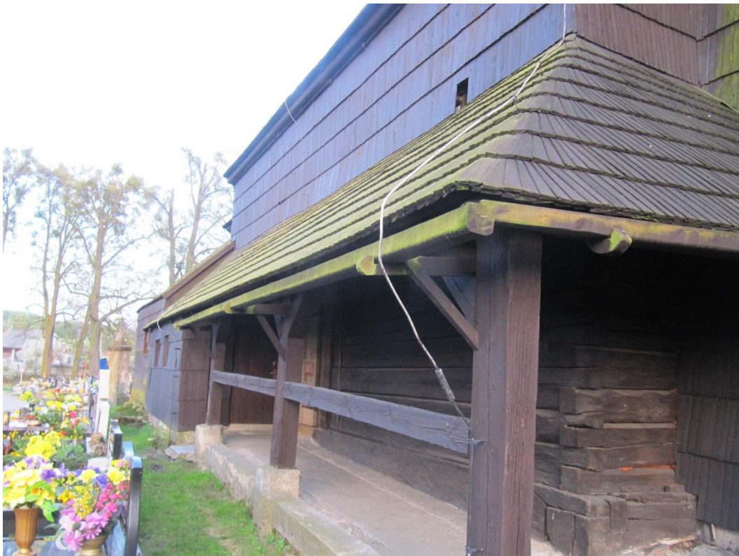
Fot. 26. Drewniane rynny pod sabotami od strony północnej przed przedsionkiem zakrystii
