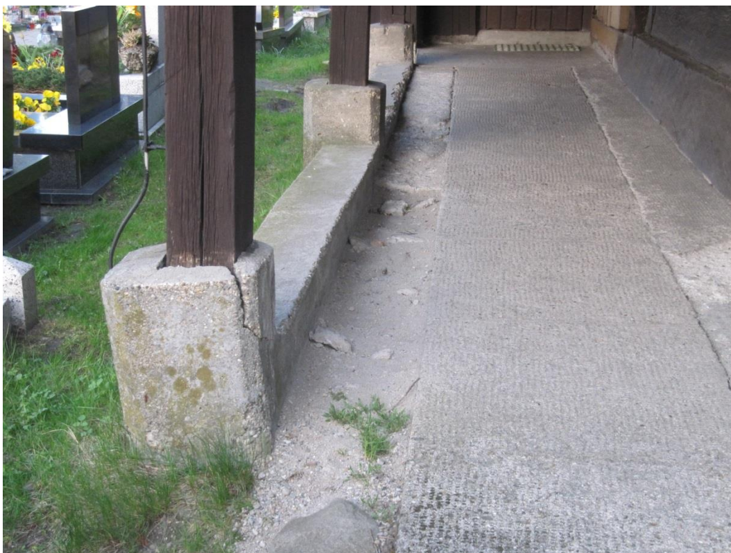
Fot. 18. Przechylony i rozłupany słupek cokołu pod sabotami
