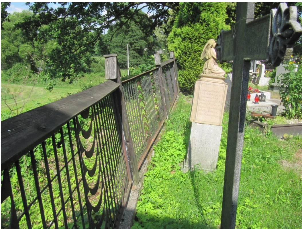
Fot. 22. Stan ogrodzenia wokół działki
