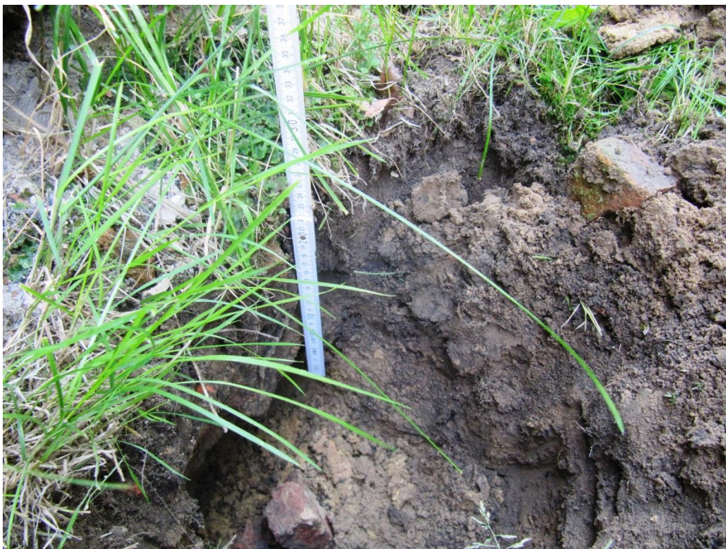
Fot. 7. Brak fundamentu pod podmurówką ścian zakrystii
