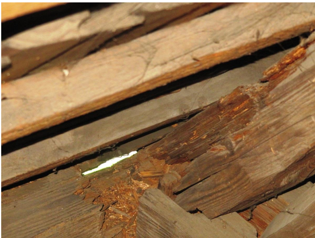
Fot. 12. Lokalne zniszczenia biologiczne drewna więźby dachowej
