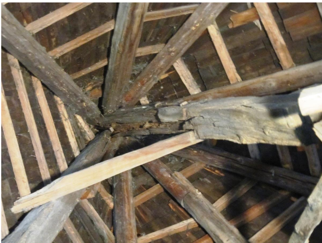
Fot. 16. Zniszczenia korozyjne krokwi i słupa w szczycie hełmu wieży – stan przedawaryjny
